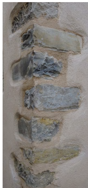
Fig. 64 - Sur-épaisseur de l'enduit
