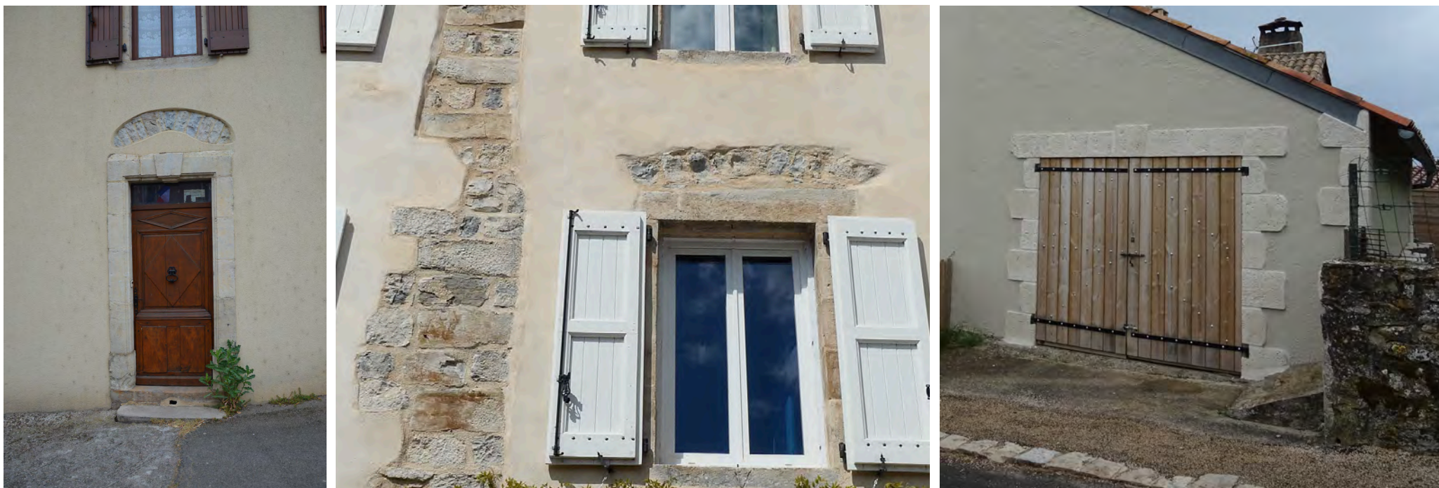
Fig. 74 à 76 - Incohérence de l'enduit
