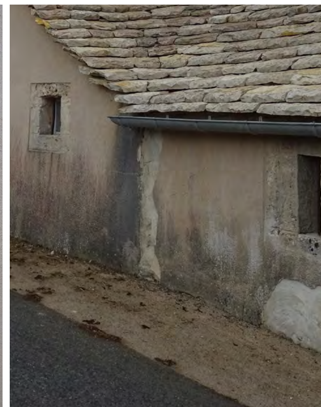
Fig. 65 - Enduit ciment et remontée d'humidité
