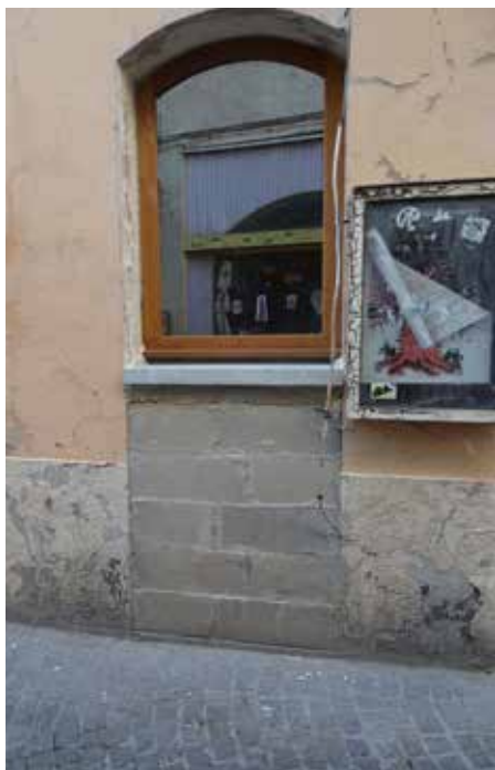
Fig. 64 - Modification maladroite de la baie
