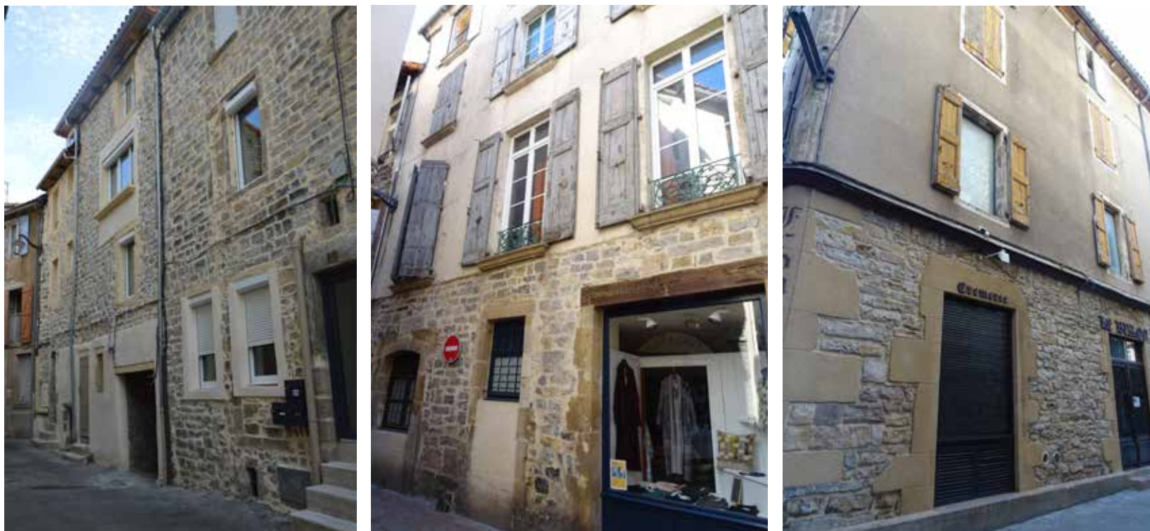
Fig. 68 à 70 - Suppression de la composition de façade, incohérence de l'enduit
