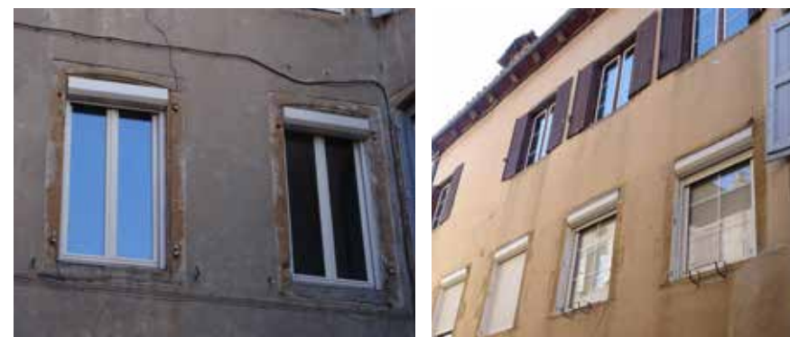
Fig. 71 à 73 - Choix de second-œuvre altérant la façade
