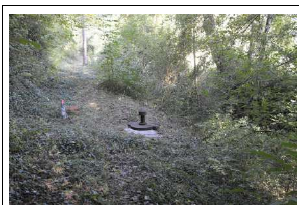
Photo 1 : situation du captage en bordure du ruisseau Trébans
