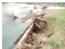
Dégradation du caisson végétal après la crue
